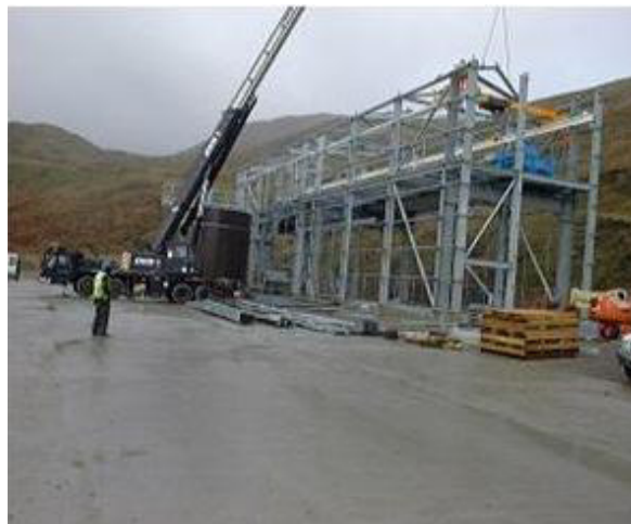
Instalación de Filtro Prensa de 2.1m 2 , Reino Unido
